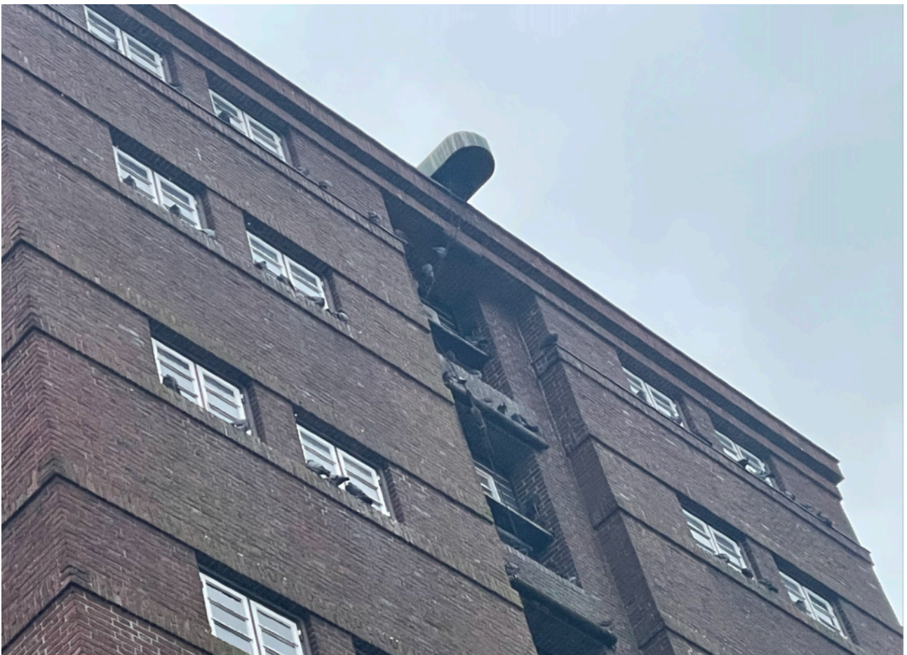
Abb.6: Auf der wettergeschützten Ostseite des Rundsilos befinden sich Fensterbänke und Gebäudevertiefungen, in denen die Tauben bevorzugt Schutz suchen, außerdem haben sie hier ihren Schlafplatz. Einige Paare brüten hier auch.
