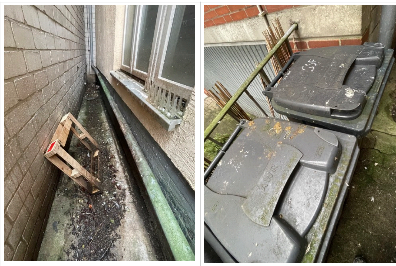
Abb.8 und 9:: Verschmutzungen auf einem Innenhof (Langebrückstraße 9) unterhalb der Brutplätze.
